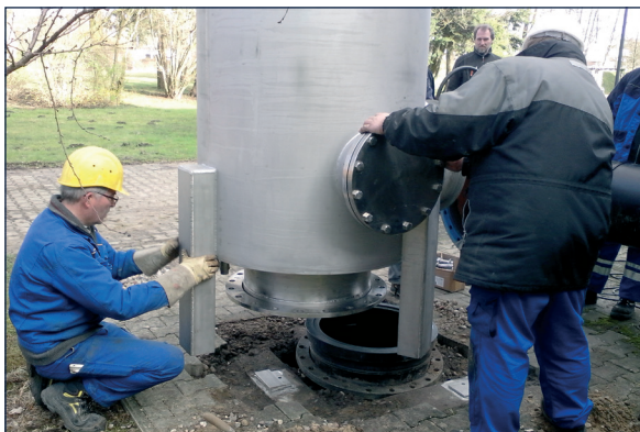
Edelstahl-Anlagenbau im Wasserwerk
